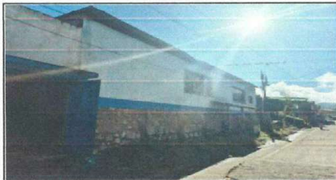
Foto 3: Repello de pared exterior circundante a la calle
